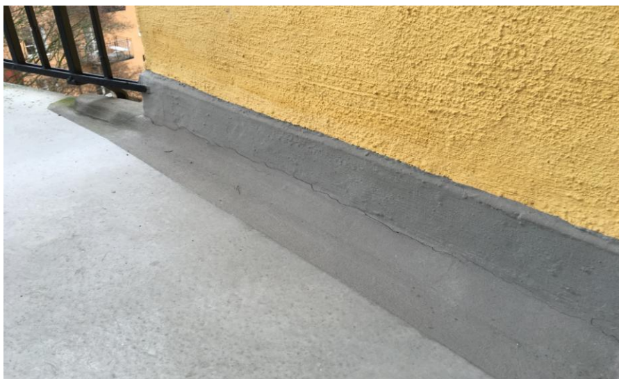
Bild 1: Sockel till balkonger från trapphus har horisontella sprickor.
