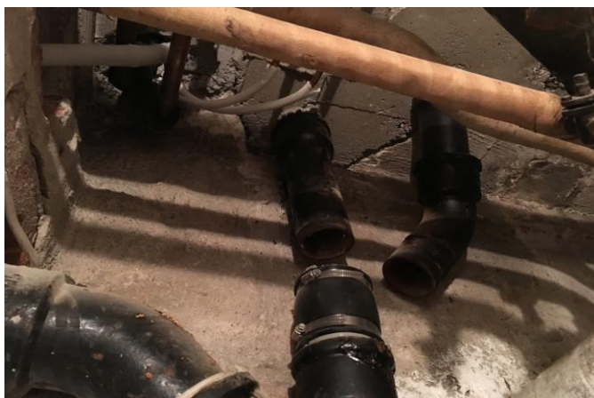
Bild 3: Gamla avloppsledningar har ej rivits bort i källare.
