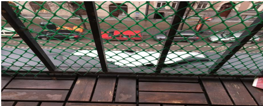
Bild 5: Plåtbleckets färgskikt har lossnat.
