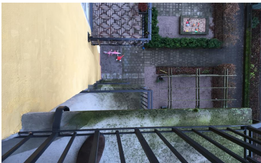
Bild 2: Algbeläggning på balkonger från trapphus.
