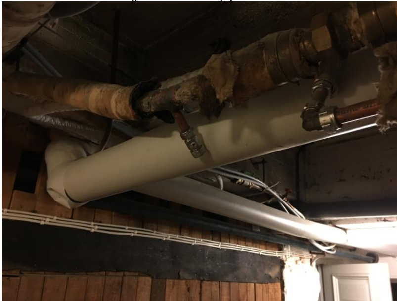
Bild 1: Blindledningar på varmvattenledning.
