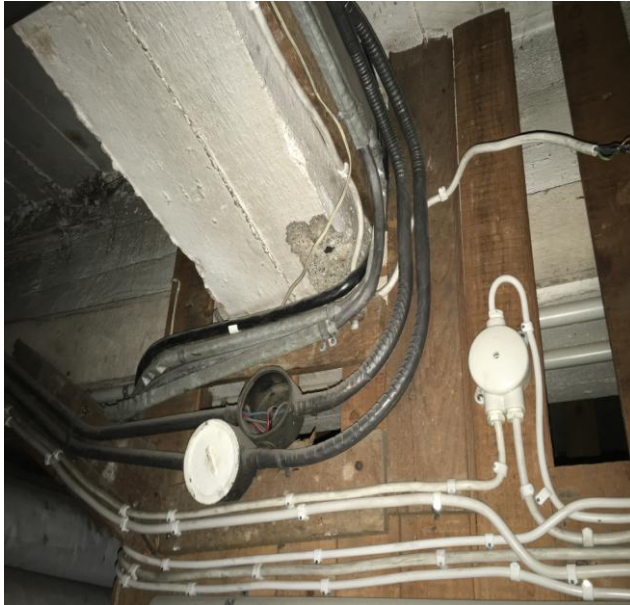
Bild 1: Ledningar ej i bruk
