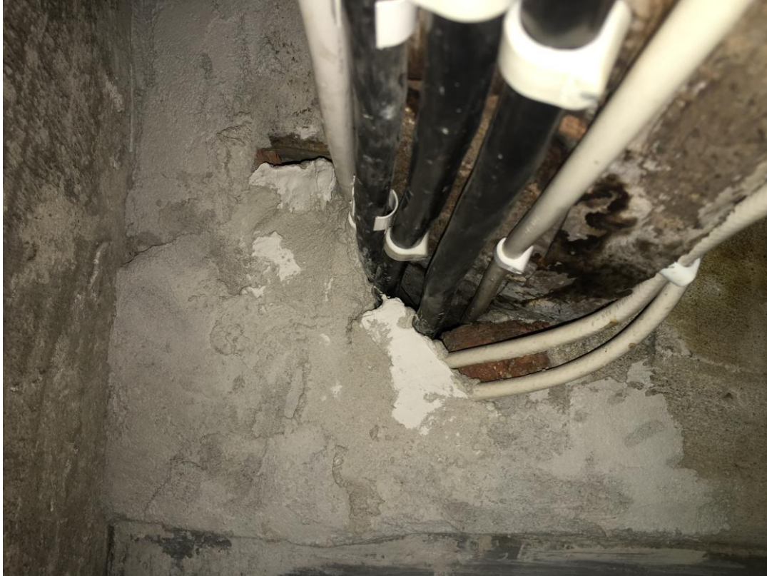
Bristfällig brandtätning i mellanvägg (brandvägg) på vind
