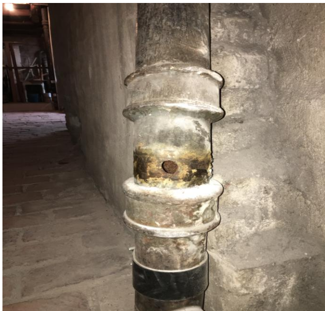
Bild 2: Hål på avloppets luftledning på vind.
