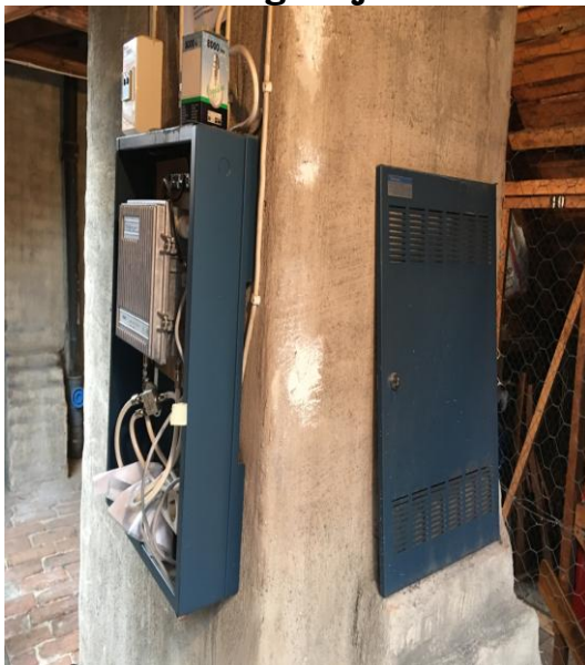
Bild 2: Ej skyddad antenninstallation
