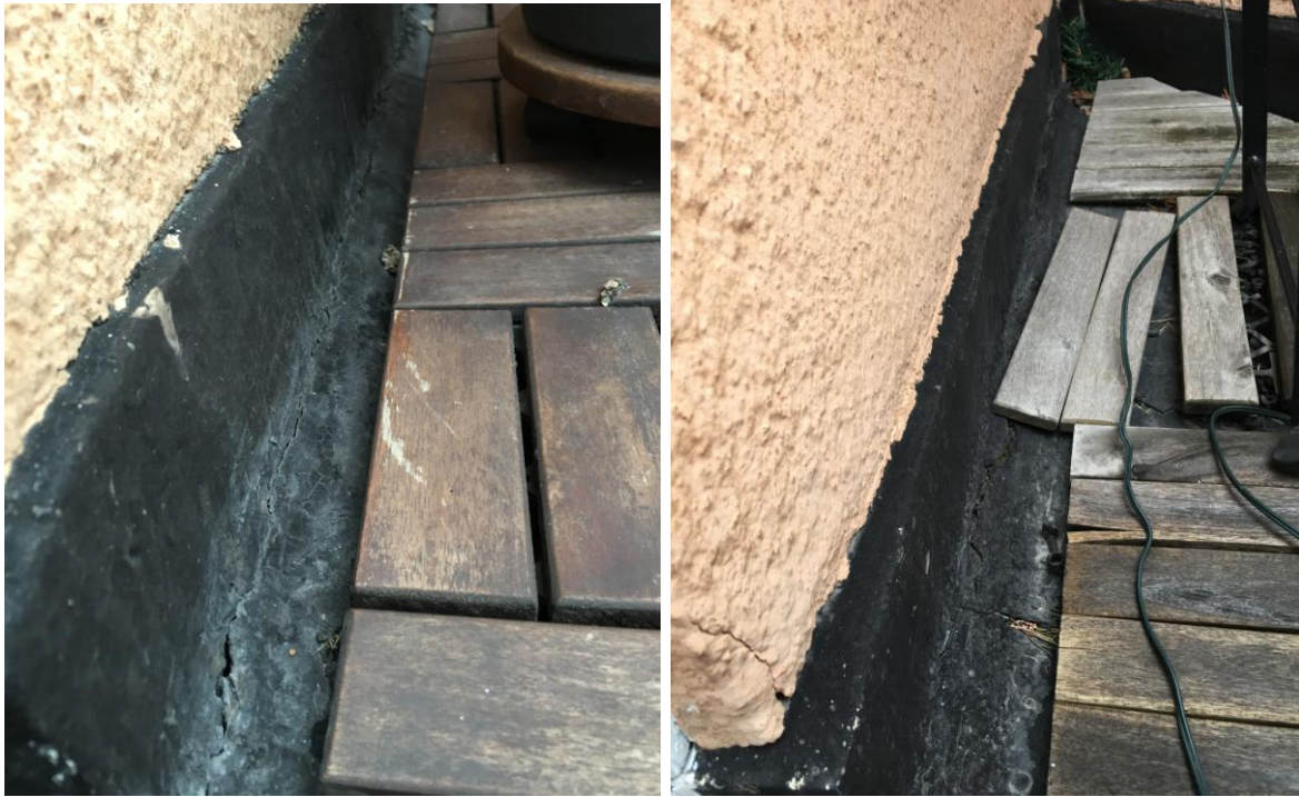
Bild 3,4: Dragsprickor i balkongens tättskikt mot vägg.
