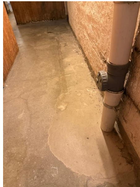
Spår av tidigare byte av rör under golv.
