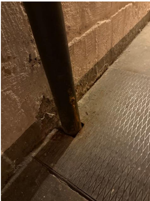
Status på liggande avloppssystem är oklart.
