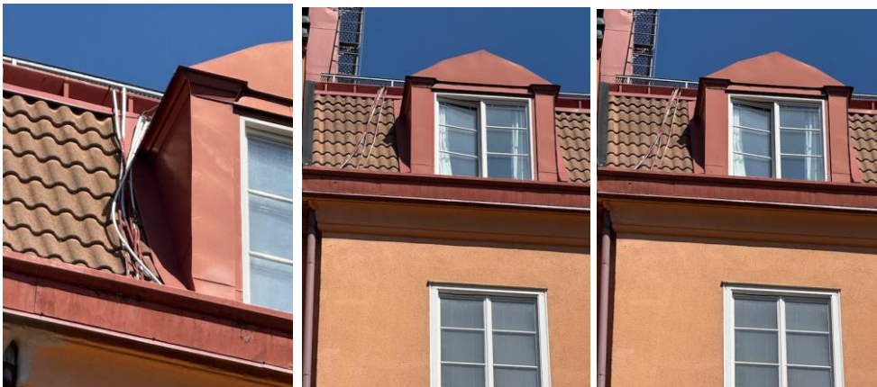
Takvärmeinstallationen mot gatan på 3 ställen hänger ner på tegeltaket.
