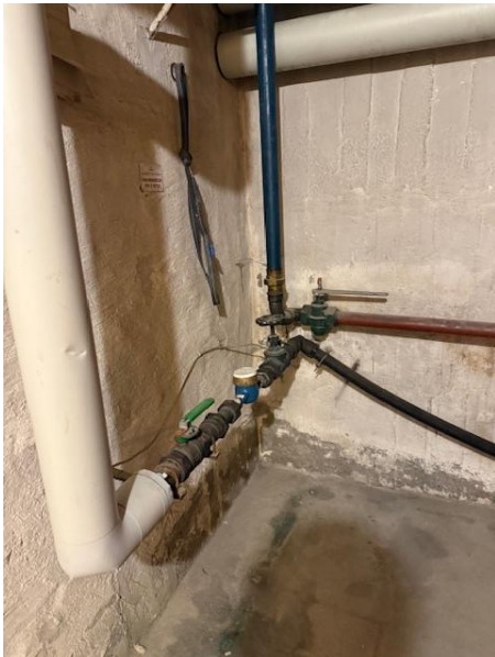
Vattenmätare i källare, uppgång 30
